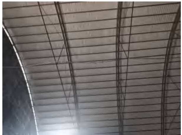
厂房内喷淋装置
